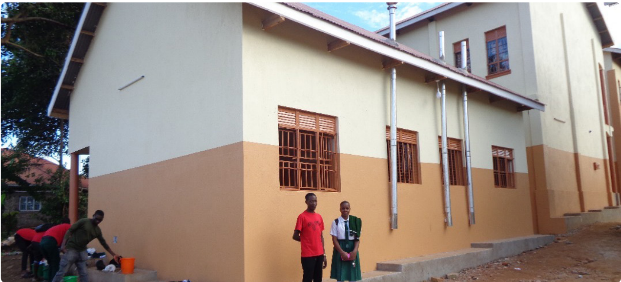
Belüftung und Abzüge des neuen Küchengebäudes
